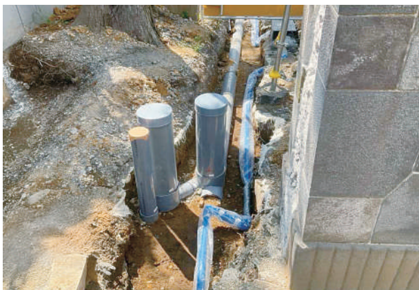
15 正門西側 給排水配管状況
