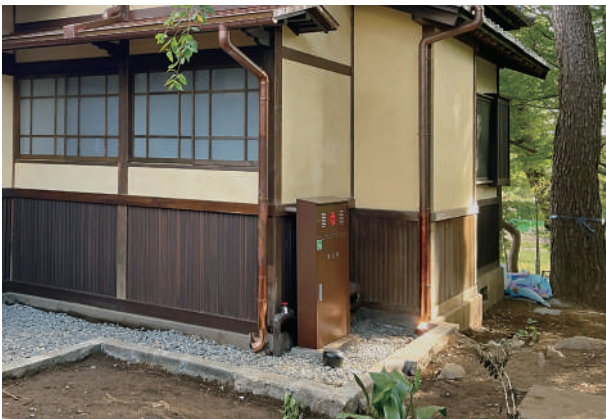
21 寝室西側 屋外消火栓
