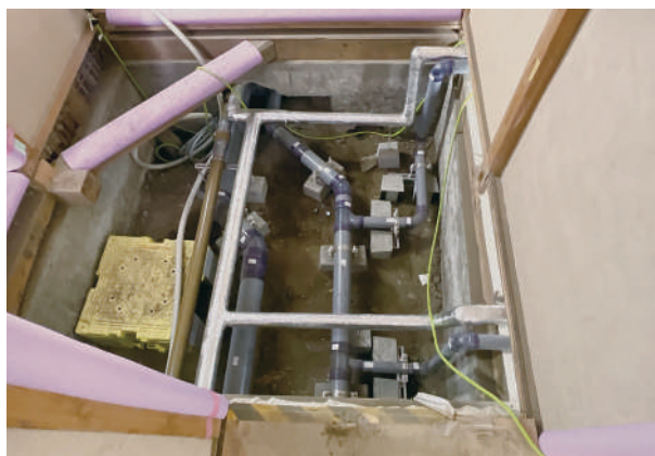
10 別棟トイレ内の配管と引込状況
