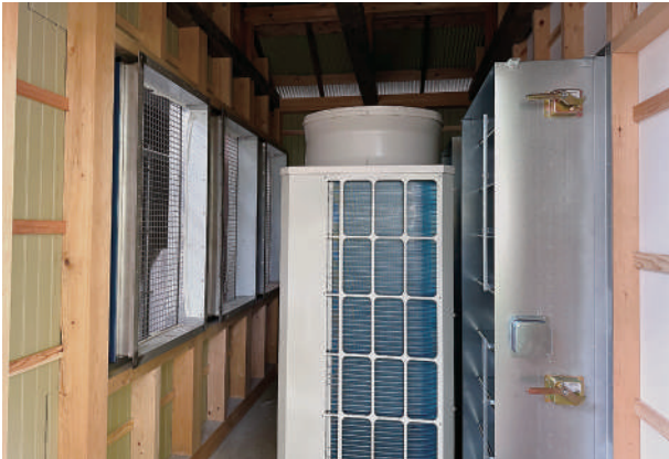
19 物置内の室外機設置状況
