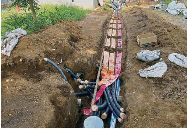
1 屋外埋設配管状況
