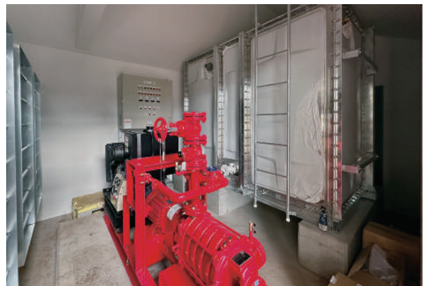
20 物置発電機と防火水槽
