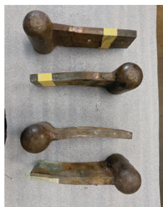
2 正門肘坪金物修理前
