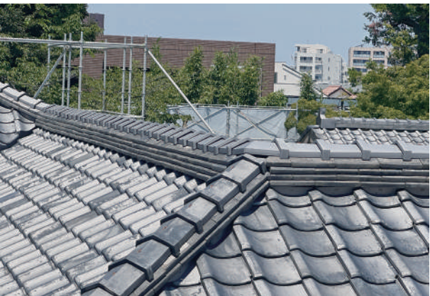
7 宝珠型瓦のない棟接合部
