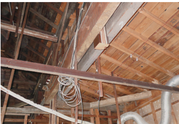
15 小屋裏に転用されていた敷居
