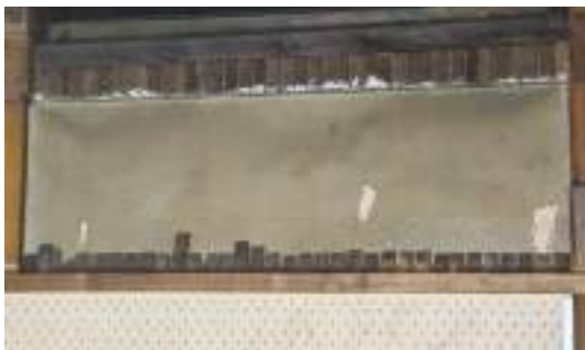
写真 5-8 解体時に確認された創建時寝室の壁紙
