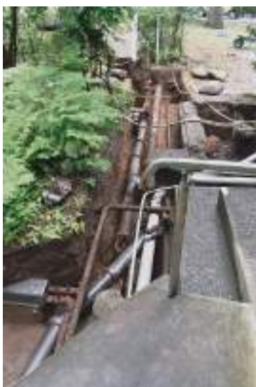
写真 3-10 土管、鉄管、塩ビ管
