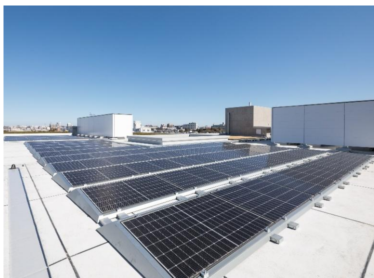
▲屋上に設置した太陽光パネル
