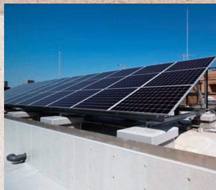
2 太陽光パネル
