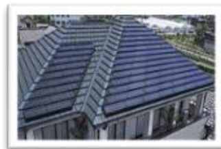
太陽光発電システム
