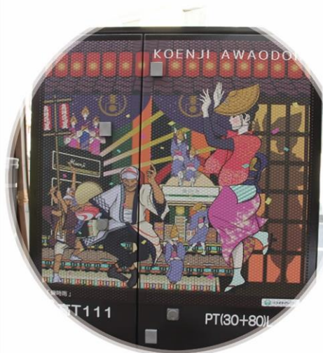
トランスボックスラッピング（東京高円寺阿波おどり）
