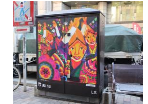
▲トランスボックスラッピング(高円寺駅周辺での事例)
