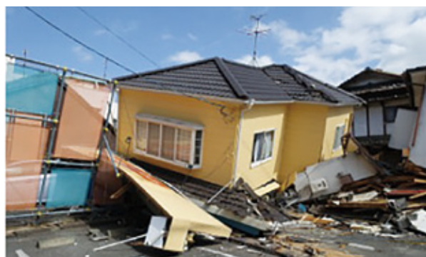
熊本地震被害状況②
