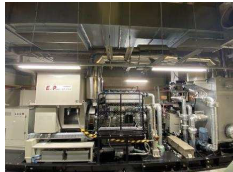
コージェネレーションシステム
