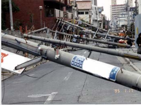
阪神・淡路大地震による電柱倒壊現場 (平成7年1月17日 出典：兵庫県)
