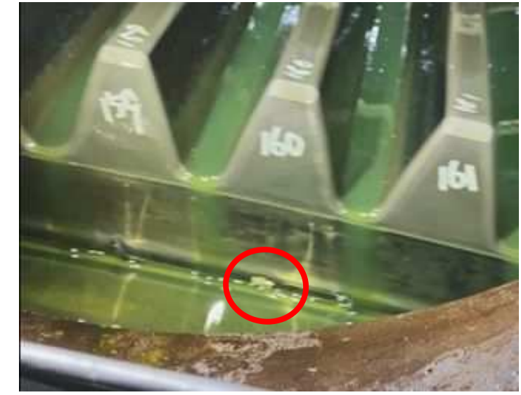
大ギヤの点検結果 （金属片が周辺固定部材との隙間に挟まれた状況）
