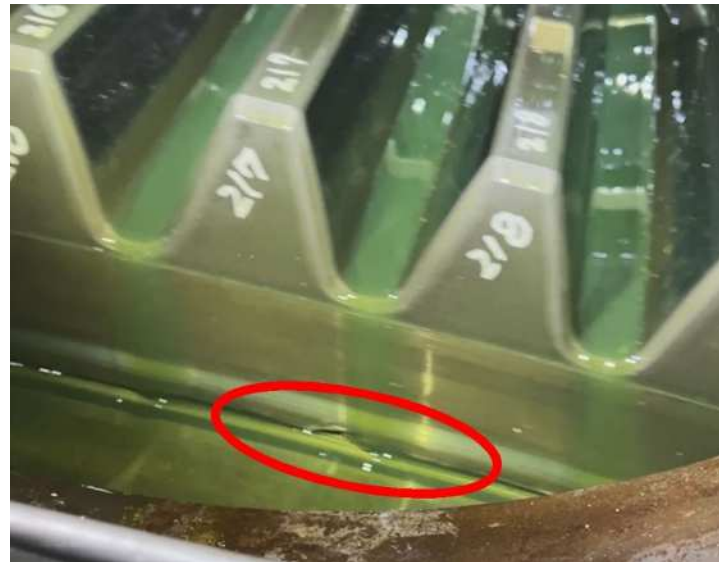
大ギヤの点検結果 （変状状況①）
