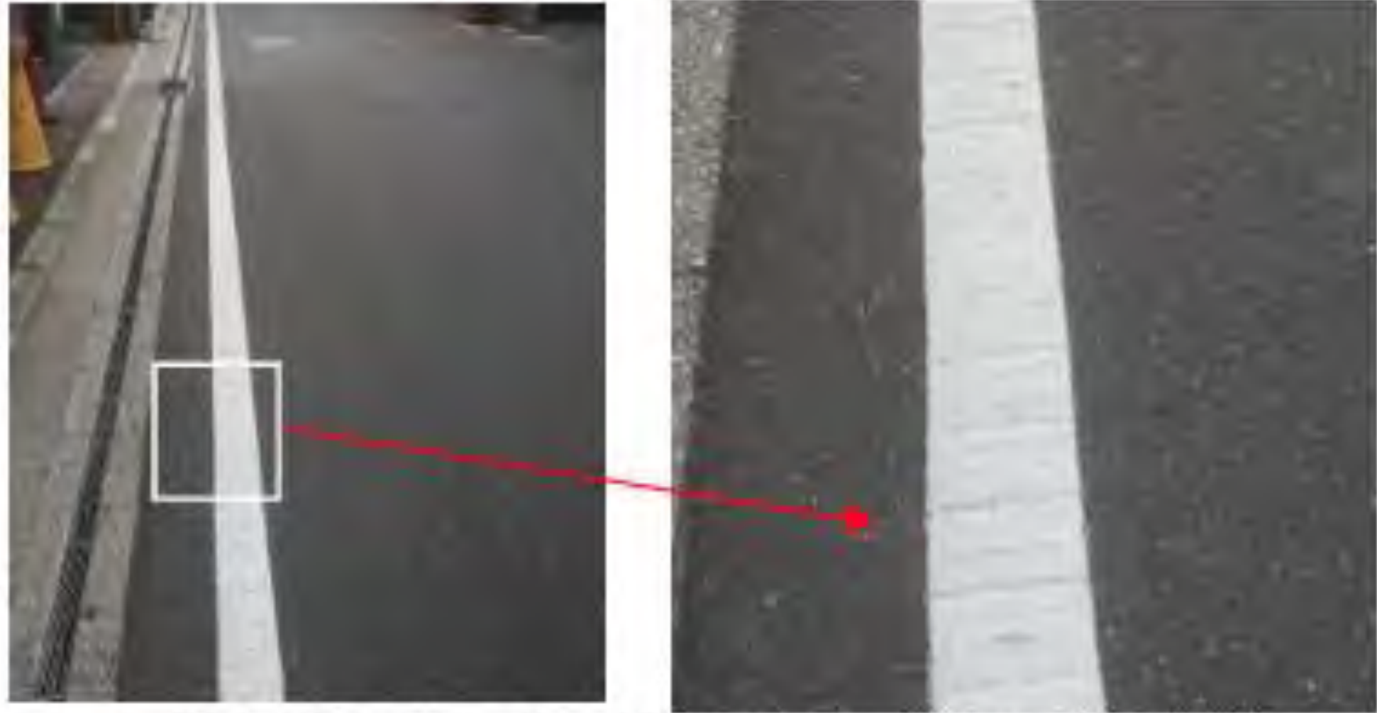
写真 2-1-25 単断面道路のリブ式の車道外側線 (大阪府豊中市府道豊中吹田線：特定道路)
