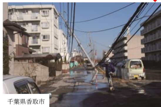
電柱の倒壊に伴い垂れ下がった電線 ↓
