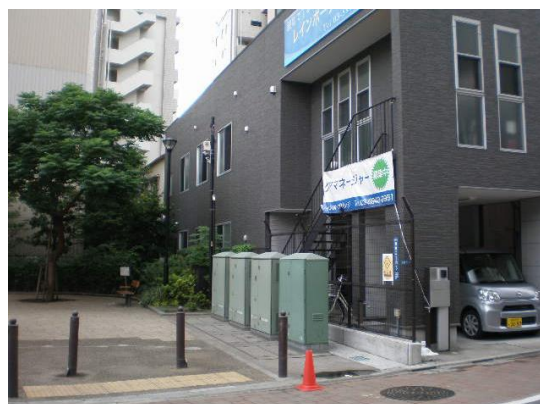
板橋区道（公園への設置事例）
