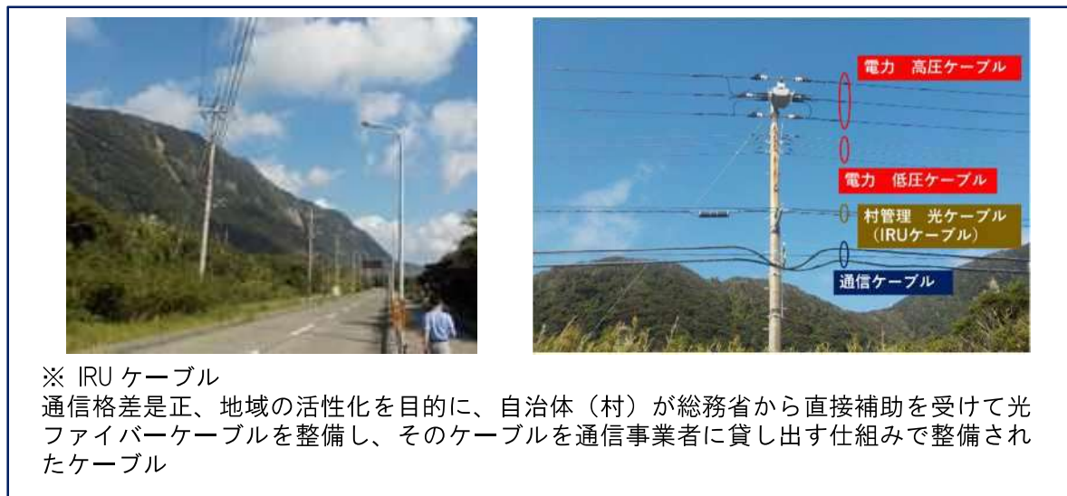
図IV-14 IRU ケーブルが添架されている島しょ地域の都道の状況
