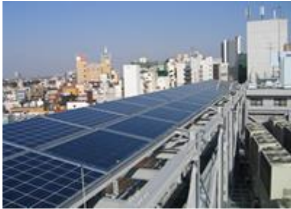
太陽光発電システム
