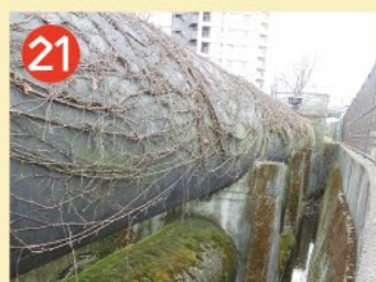
水道鋼管 地下に埋設されている水道管が井の頭線を跨ぐために、上下二段の直径2.4m(上)と1.8m(下)の水道鋼管として地上に露出しています。
