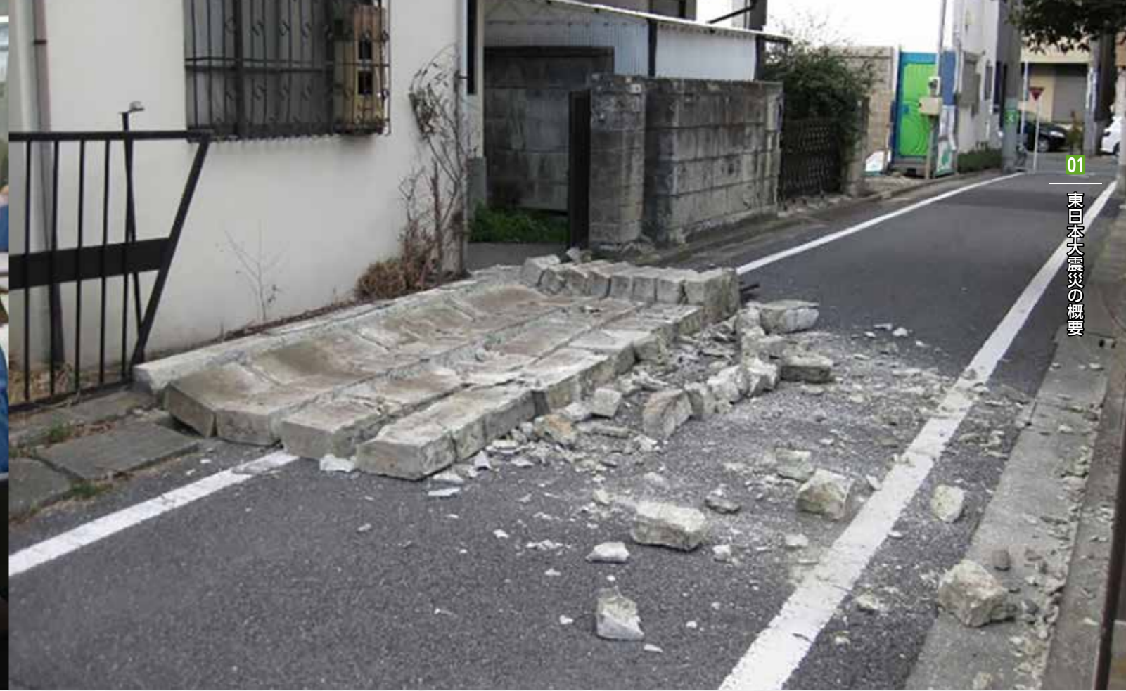
地震により、区内のブロック塀が倒壊
