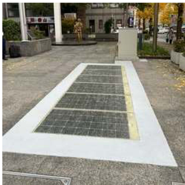
杉並区役所前に設置された路面太陽光発電システム(杉並区ホームページより)
