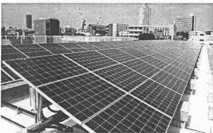
区立学校の屋上に設置する太陽光発電パネル。緊急時には震災救済所の電源として利用します。
