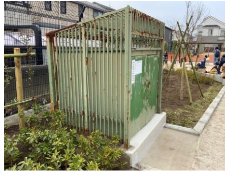
ポンプ庫 ・ 防火水槽
