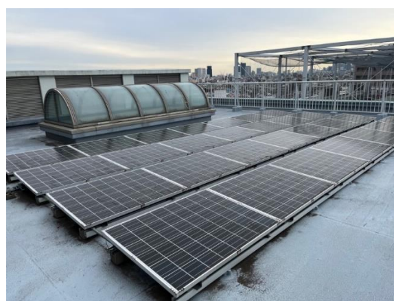
太陽光発電パネル（本庁舎屋上）
