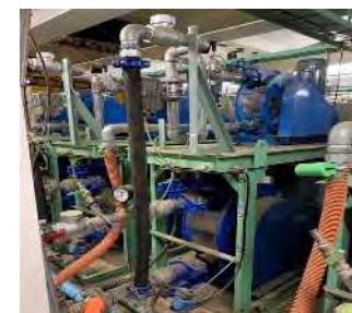
添加材注入ポンプ
