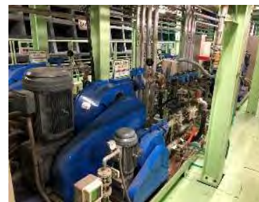
添加材注入ポンプ
