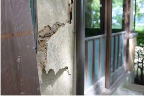
写真11 2018年6月18日大阪北部地震による被害
