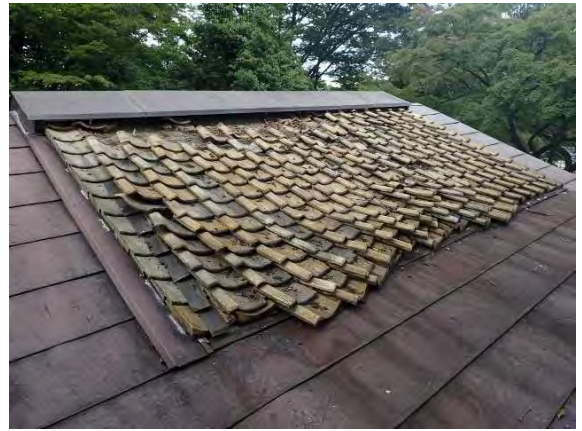
写真12 2018年9月4日台風21号による被害
