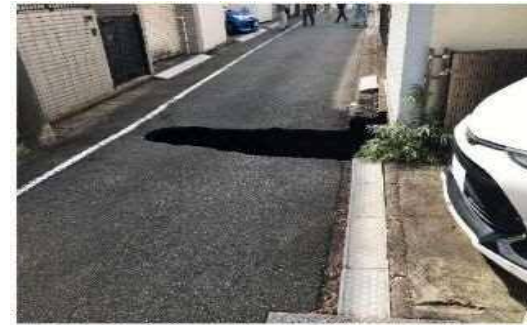
陥没箇所（2020年10月18日 12:30）
