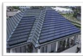
太陽光発電システム
