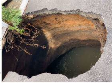
陥没箇所状況写真
