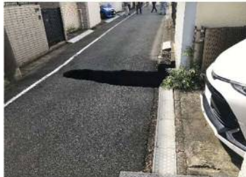
・陥没箇所の状況 (令和2年10月18日12:30)
