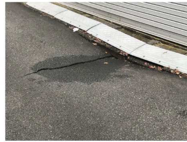
写真3 陥没箇所(2020年10月18日_11:50_舗装亀裂)
