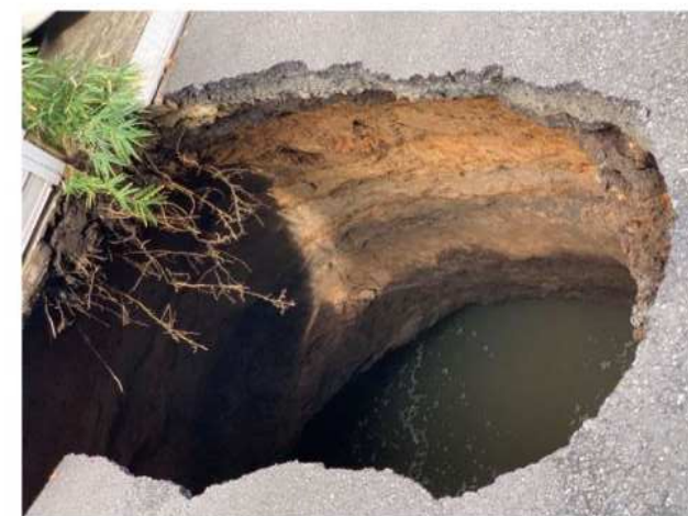
写真6 陥没箇所(2020年10月18日_13:00_西側から撮影)
