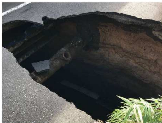
写真5 陥没箇所(2020年10月18日_13:00_東側から撮影)
