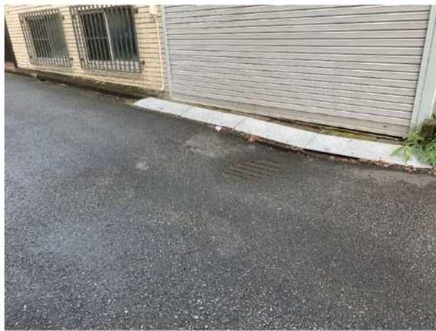
写真2 陥没箇所(2020年10月18日_9:30水たまり)
