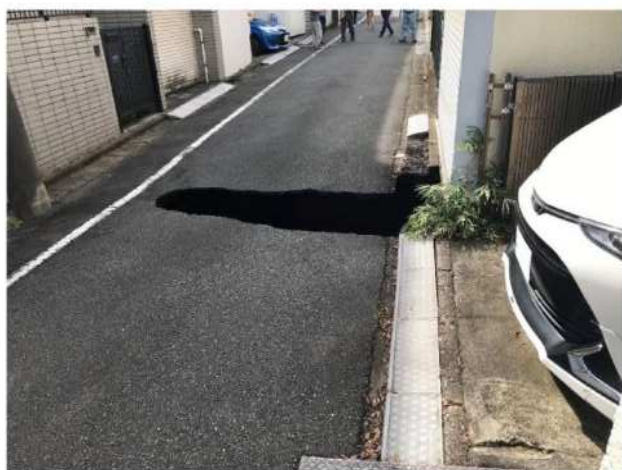
写真4 陥没箇所(2020年10月18日_12:30)
