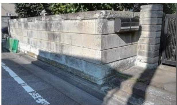
▲ブロック塀改修前
