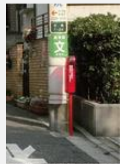
▲街頭消火器の例
