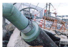
阪神・淡路大震災の時の中圧ガス導管
