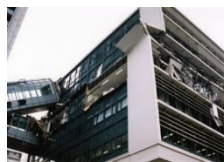
↑ 阪神・淡路大震災での神戸市役所の倒壊
