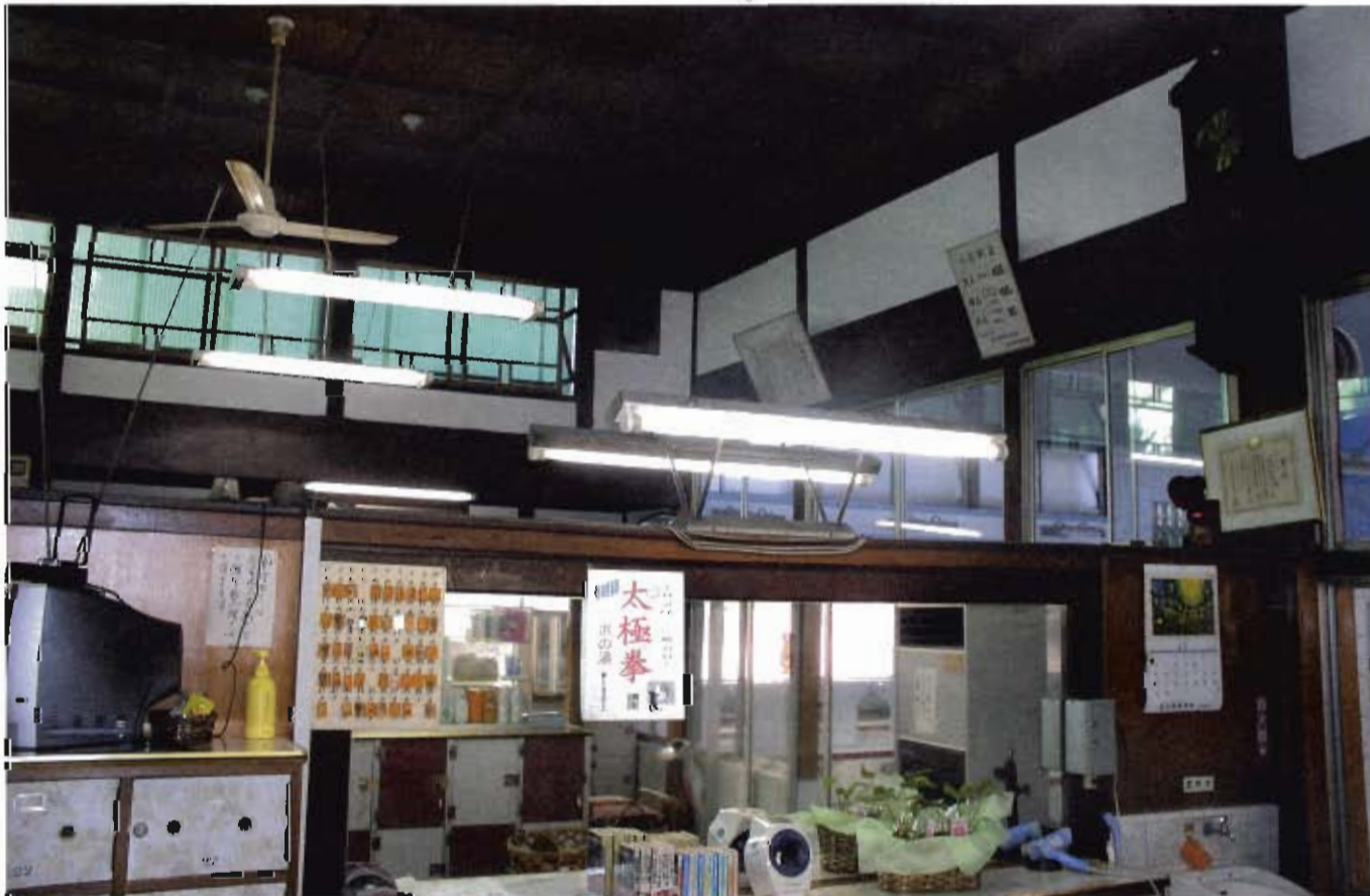
創業昭和31年、お店の中はほとんど創業当時のままとか。壁の補修や設備の修理などご主人自ら、手厚く大事にお手入れをしているそうです。天井のお掃除は、大仏様のすす払いのように笹のホウキを使用。
