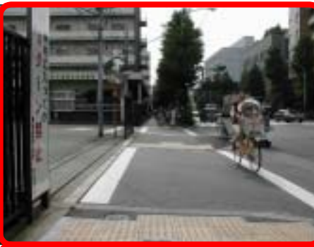
歩道が波打っている
