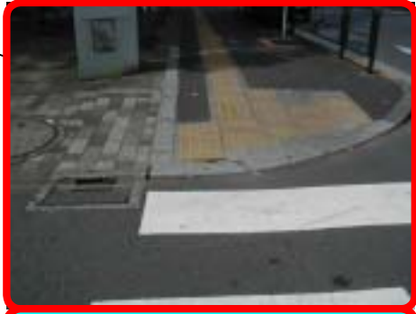
歩道の切り下げ部が痛んでいる
