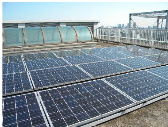
【区役所本庁舎に設置中の太陽光発電パネル】
