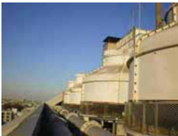
(西棟屋上の冷却塔)
