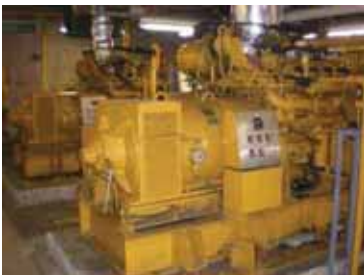
(地下 3 階のコージェネレーションシステム)
