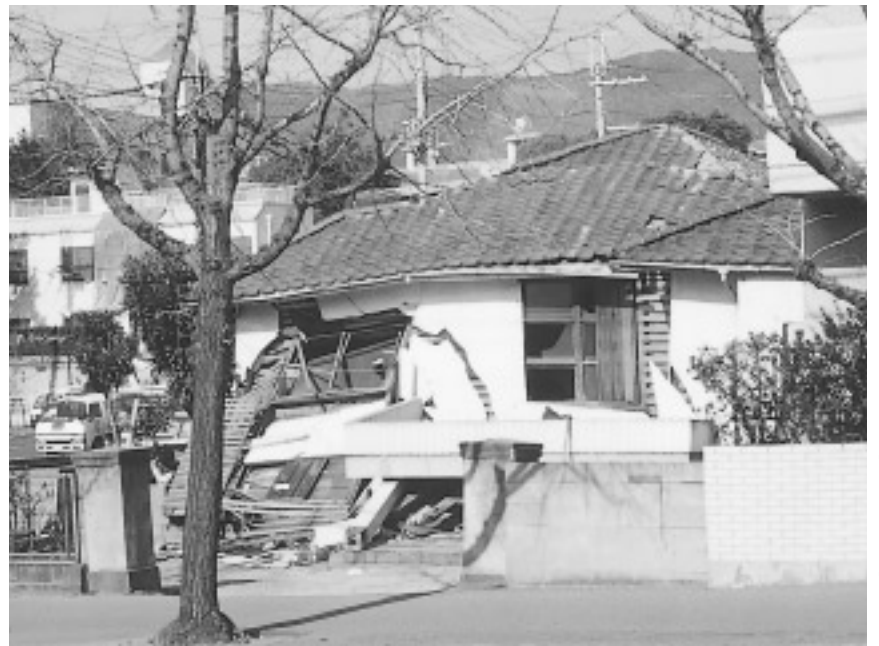
阪神・淡路大震災で壊れた家(7年1月)
