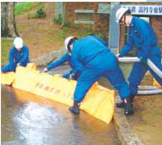
地下室への浸水防止(5月14日の水防演習)
