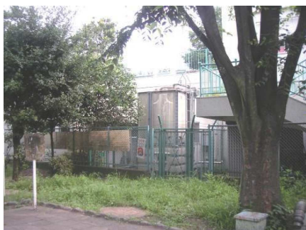
隣接する公園から見える設備機器
