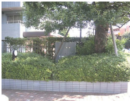
目立たなくするために、高圧キャビネットを植栽帯の中の少し奥まった場所に設置
