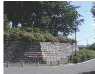
擬石積み (善福寺川緑地)
